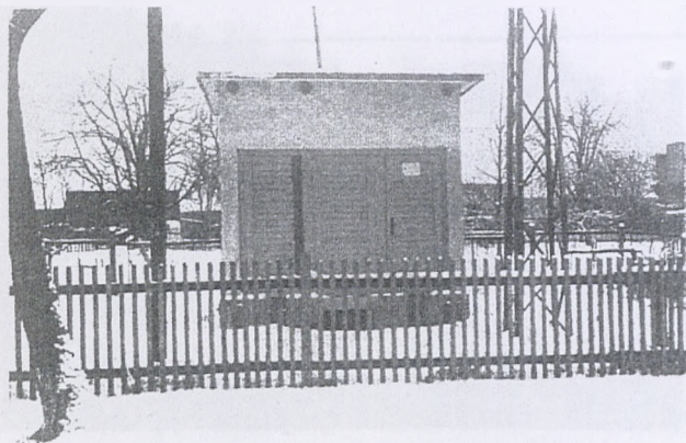
Ryc. 15. Stacja transformatorowa w Biertułtowach.
