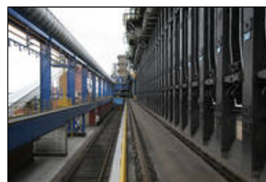
Bateria Koksownicza wraz z instalacją odpylania Koksownia Radlin
